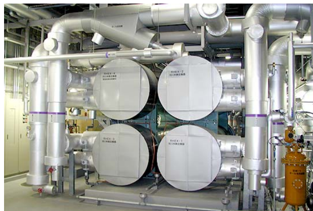
写真4 河川水熱交換器
