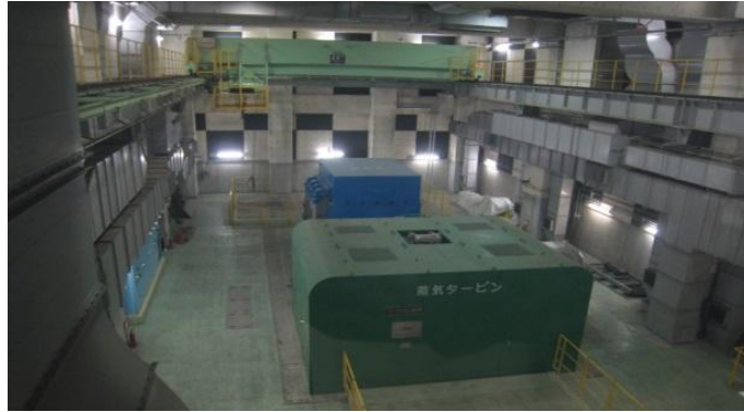
写真 2 廃棄物燃焼処理熱を利用する発電用蒸気タービン
