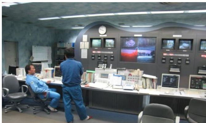
（写真 4）。中央制御室風景
