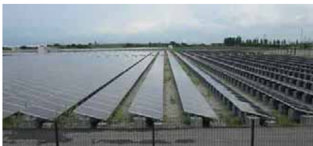
写真 1 太陽光パネル設置状態
